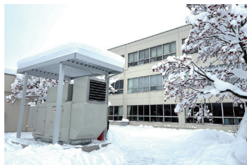
栗山小学校に設置した、非常用発電設備
