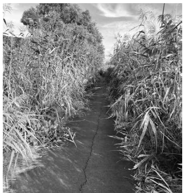
雑草等で塞がれた河川敷沿いの遊歩道
