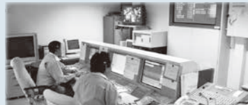
平成12年に導入した消防緊急通信指令装置
