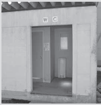
トイレは外から丸見えで男女の区切りもない
