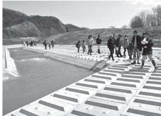
サーモンロード 昨年3月に完成した栗沢頭首工の魚道。魚道調査でサケの遡上も確認されています。
