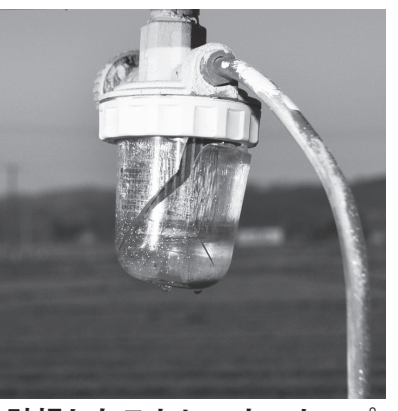
破損したストレーナーカップ
