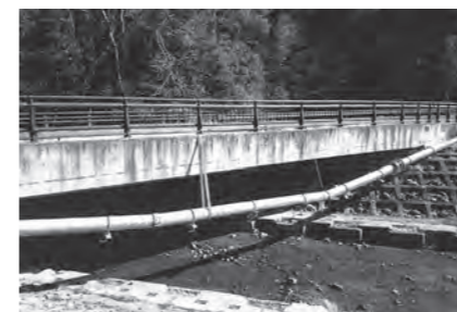
小田地区地藏堂橋（水道管のようす）
