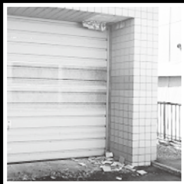
施設のひび割れ（図書館）
