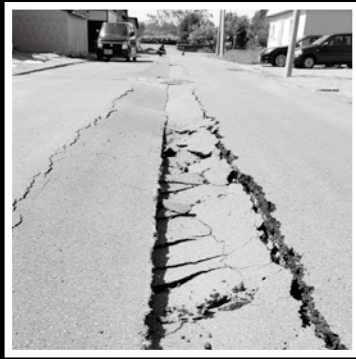
地割れの発生（湯地）
