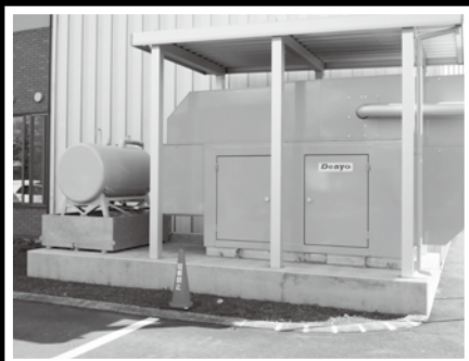
令和2年に新設された非常用発電機（カルチャープラザ「Eki」）
